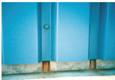
рис.1 Следы скрытой коррозии
